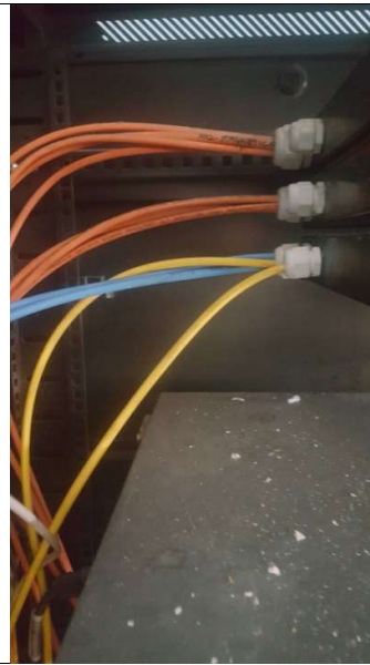
Rack Esistente FO Esistenti
