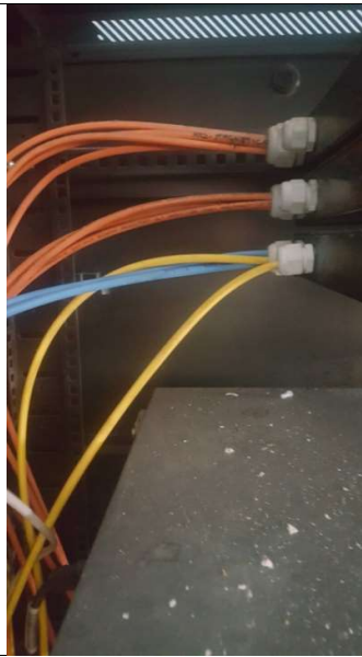
Rack Esistente FO Esistenti
