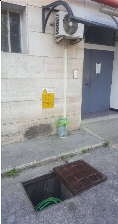
Pozzetto di uscita FO
